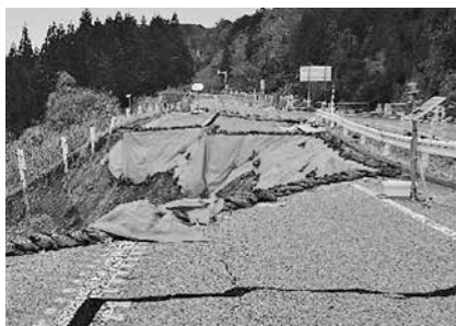
▲能登自動車道は、所々で崩落した道路の隣に仮設道路が造られていた
