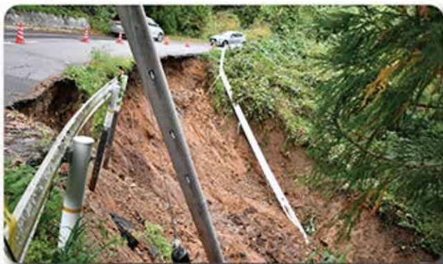
▲崩落した国道403号(市野川地区)
