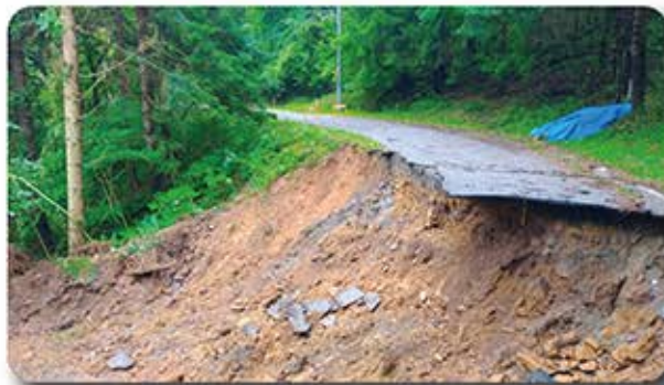
▲村道が崩落(聖高原)
