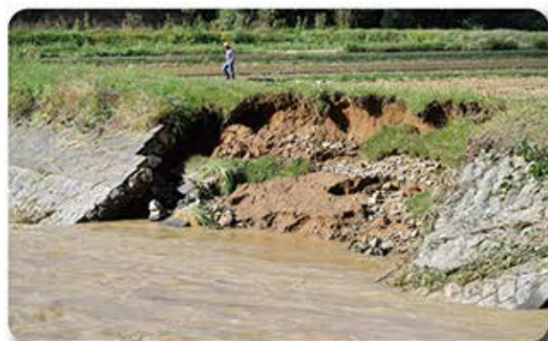
▲麻績川護岸崩落(砂原地区)
