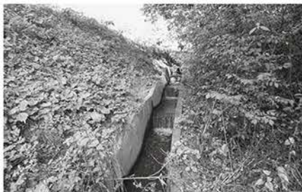
▲老朽化した用水路
