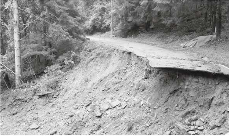
▲聖高原別荘地内の道路被害
