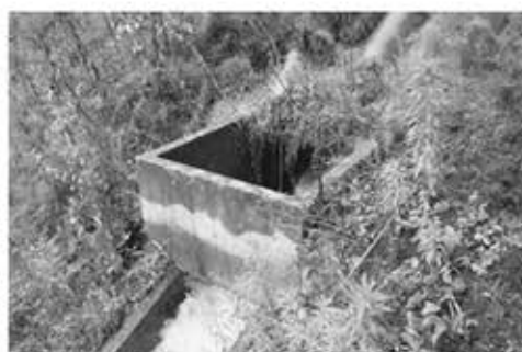
▲老朽化した水路
