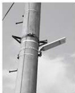
▲整備されたLED防犯灯
