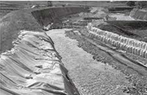
復旧を待つ姫川護岸
