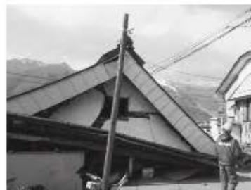
神城断層地震で被災した建物
