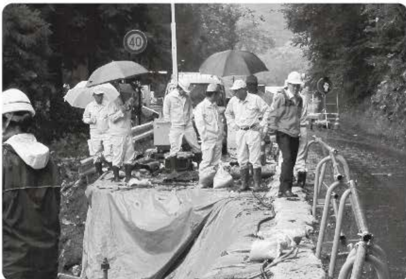
災害現場を確認
