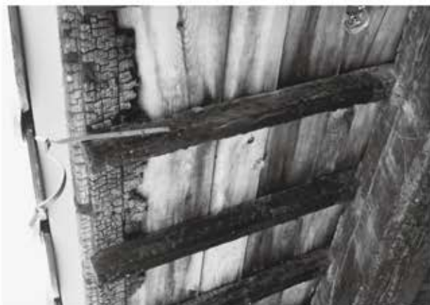
▲東側別棟に生々しく残る火災の焼け跡
