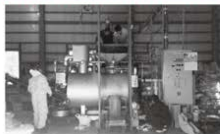
▲12年が経過した現在の処理機械
