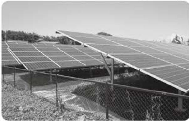
太陽光発電施設
