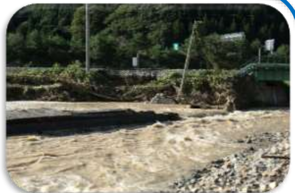
令和元年度 台風 19 号の豪雨 により堤防が決壊した麻績川
